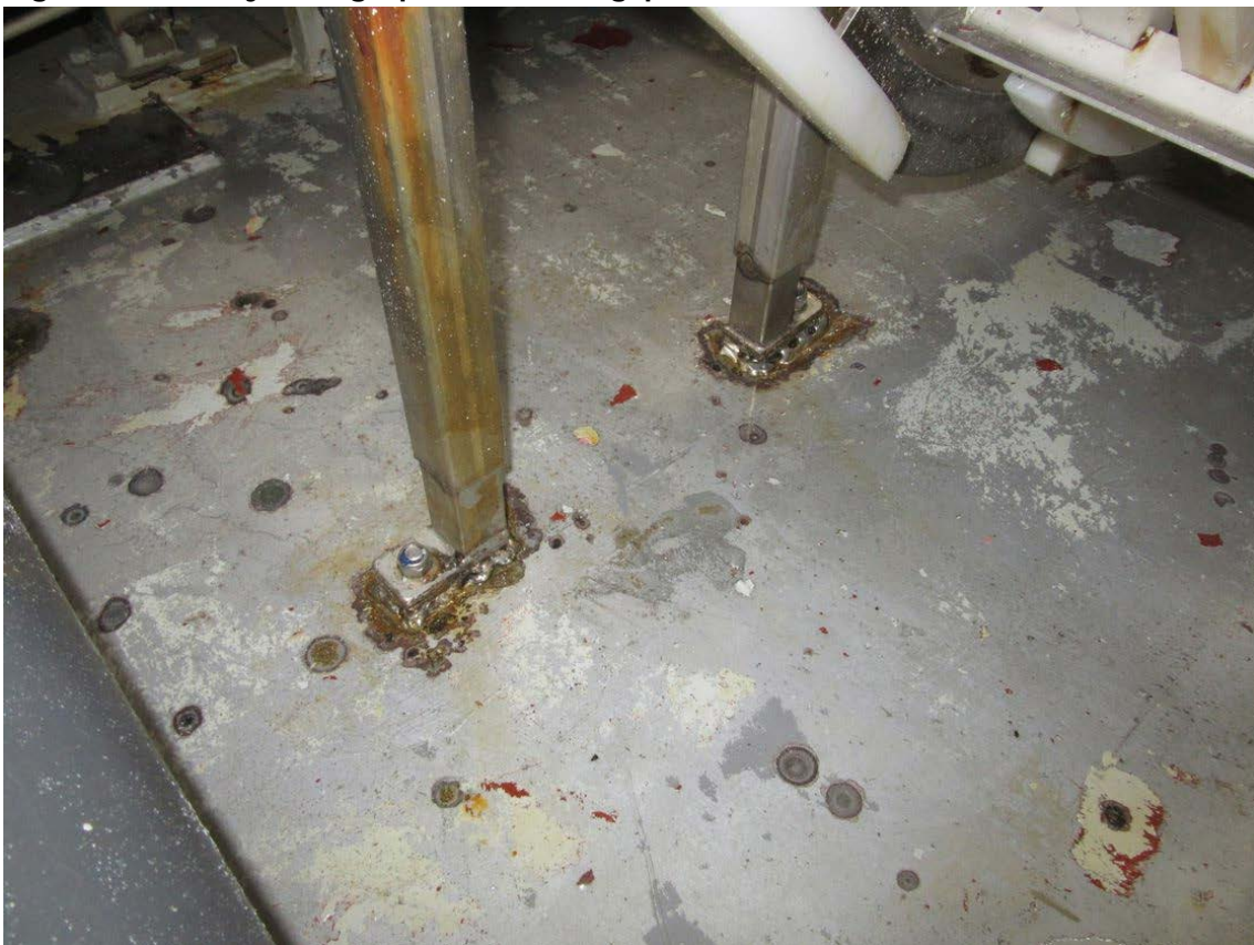
Figur 4-7 Støtteben og doblingsplater i rustfritt stål sveist på karbonståldekk. Sveisene har hulrom og er av varierende kvalitet.
