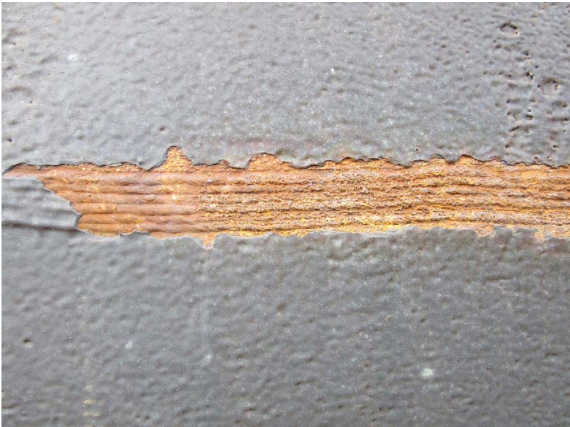
Figur 4-45 Nærbilde av sveis med korrosjon
