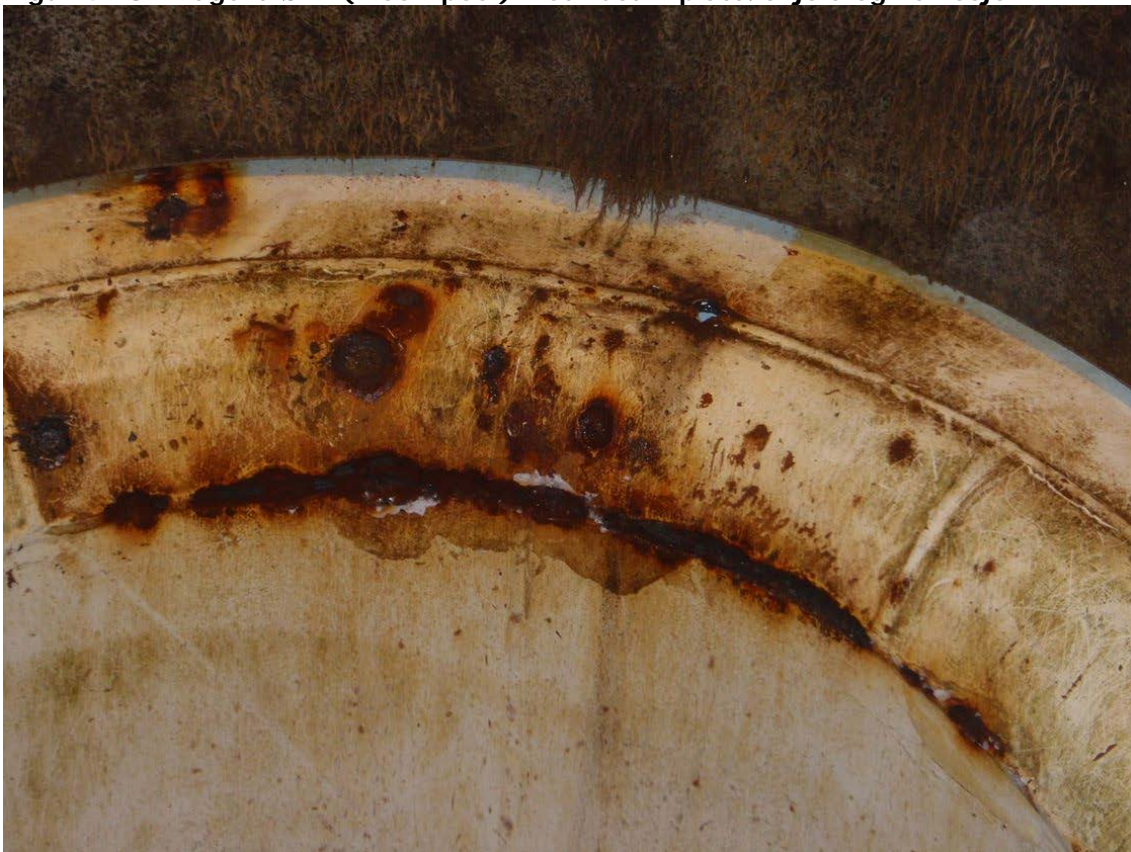
Figur 4-19 Nærbilde av korrosjonsskade i sveis
