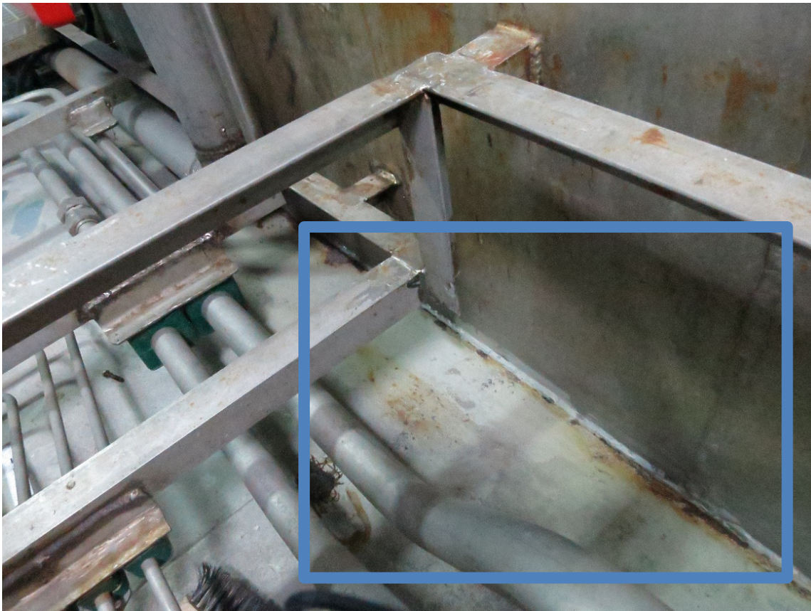
Figur 4-10 Korrosjonsangrep i overgang mellom karbonståldekk og rustfritt skott, indikert med blå firkant
