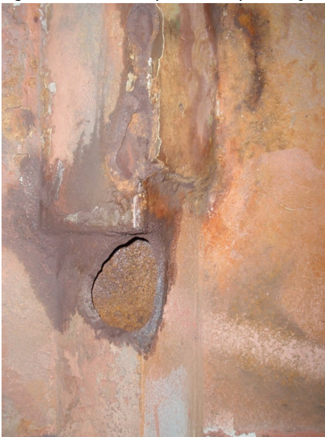
Figur 4-29 Korrodert karbonstål sideplate i sjøkisten fra Figur HOLD. Midlertidig reparasjon er gjort ved å sveise på en doblingsplate
