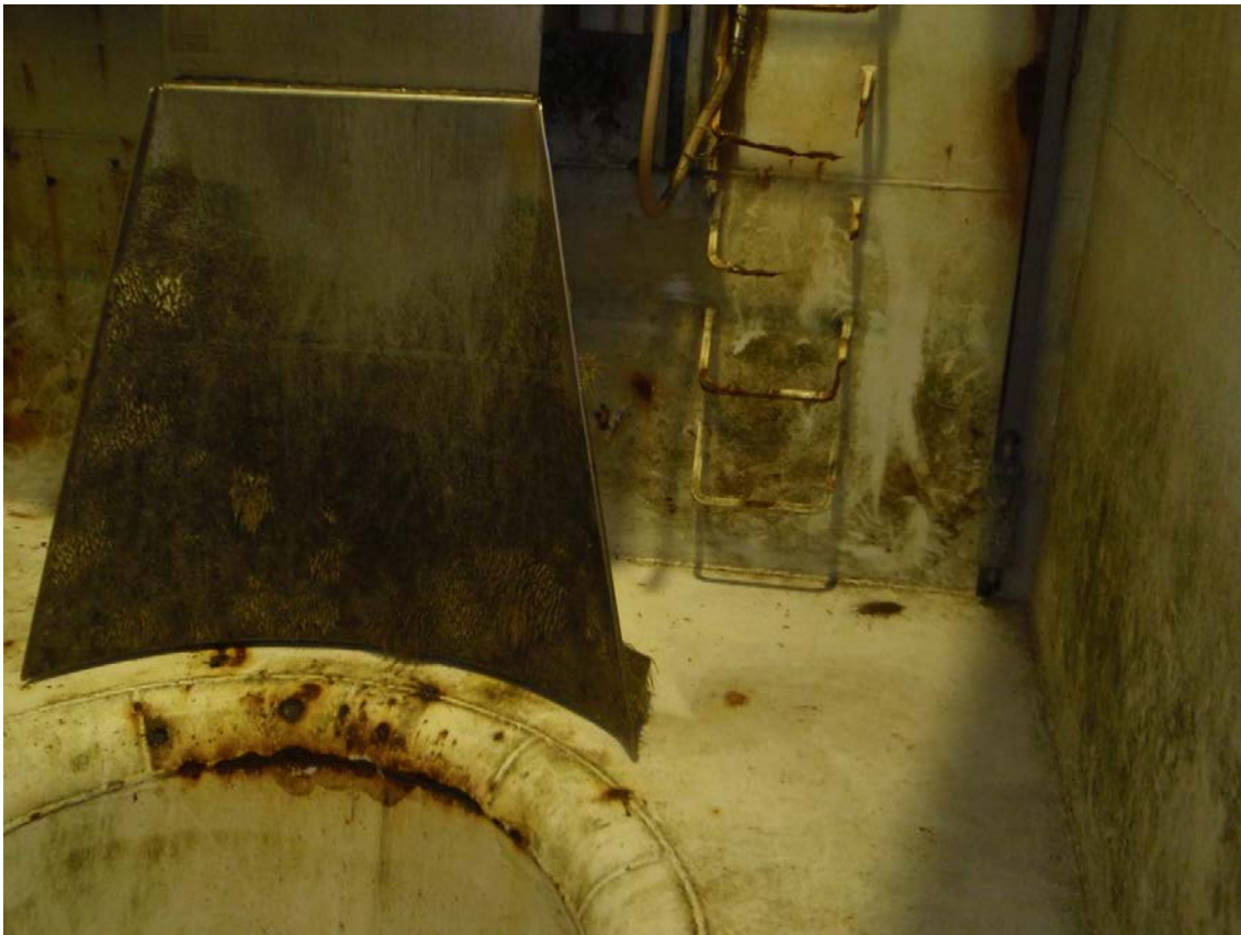
Figur 4-18 Dragerbrønn (moon-pool) med rustfri plate/skjold og korrosjon
