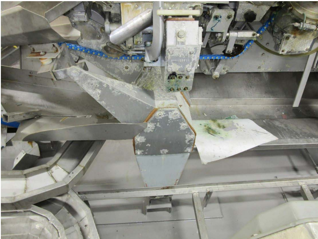
Figur 4-15 Korrosjon av en fileteringsmaskin på utstyrsplater i aluminium rundt bolter i rustfritt stål.
